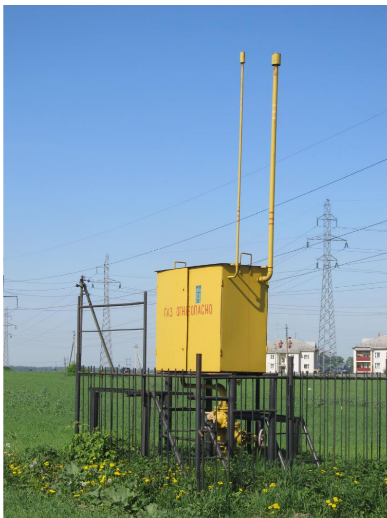
Рисунок 13. Шкафной газорегуляторный пункт.
