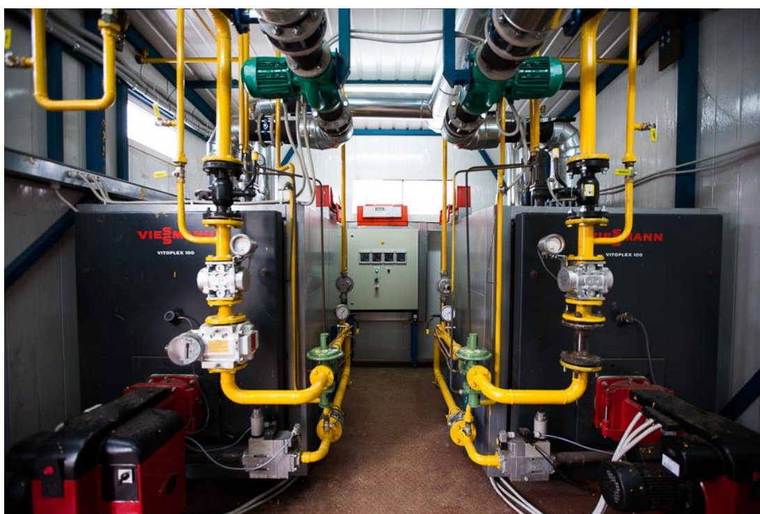
Рисунок 2. Внутренний вид котельной.
